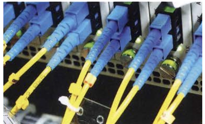
FIG. 12 – Baie de raccordement des fibres optiques. Chaque élément correspond à un abonné.
