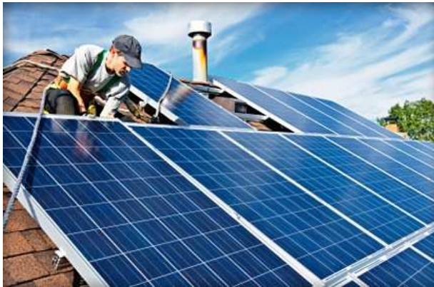
FIG. 5 – Panneaux photovoltaïques sur un toit.
